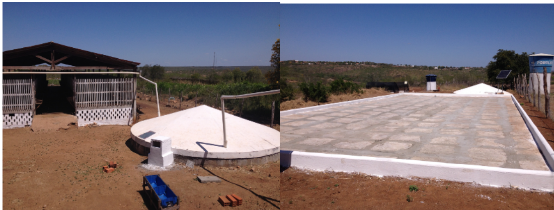
Figura 4: Dois sistemas de captação e armazenamento de água da chuva (1ª água – coleta do telhado; 2ª água – coleta em superfície calçada) (Piranhas, AL – 2015)
